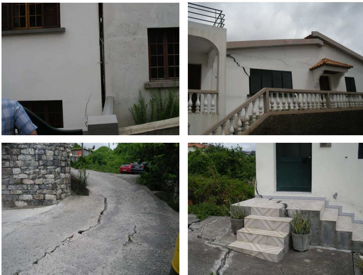
Figura 7 – Fendas nas habitações e nos arruamentos existentes em julho de 2008
